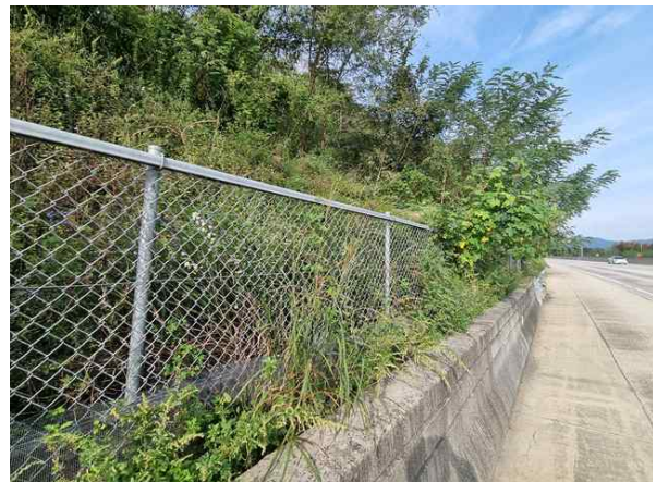
하부 야생동물유도울타리 전경
